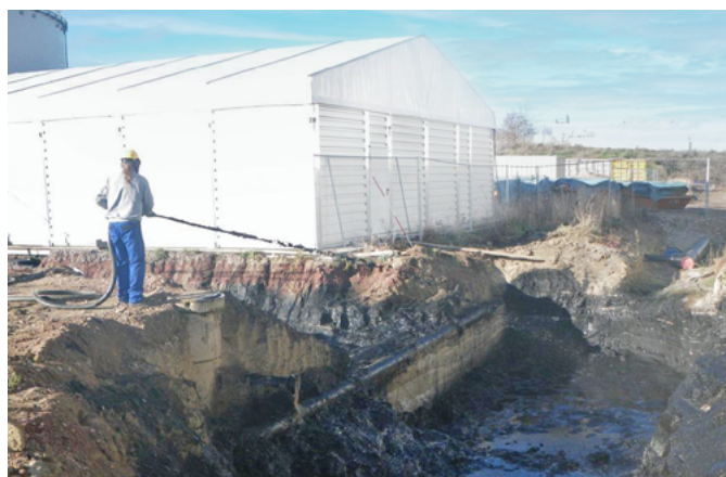
Un agent des services de terrain applique PetroFix par pulvérisation sur les parois et en fond de fouille.
